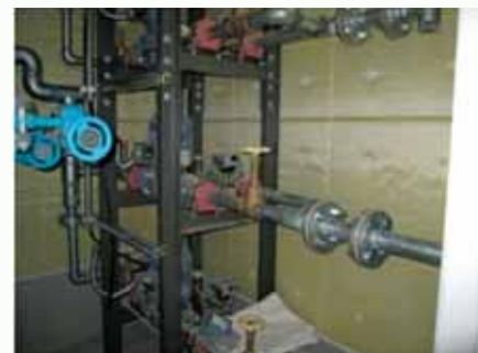
分散ポンプシステム
