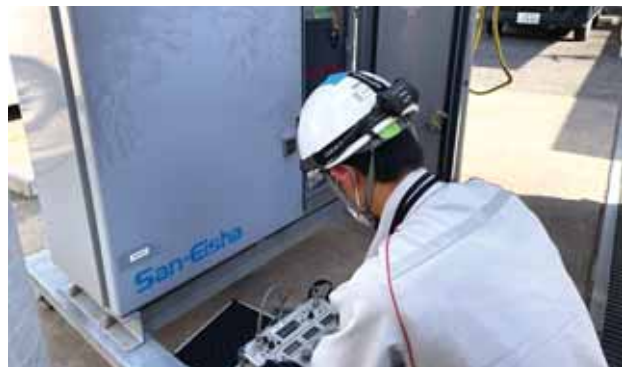
地絡方向継電器試験
